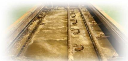
Sistema de tratamento de água (Tratamento de remoção de escórias)
