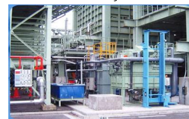
Sistema de transformação de lama em combustível
